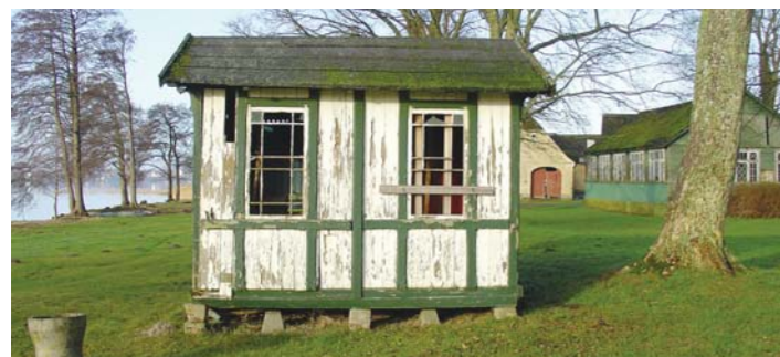
Keglehuset kan ikke restaureres. Et nyt må bygges efter mål.
